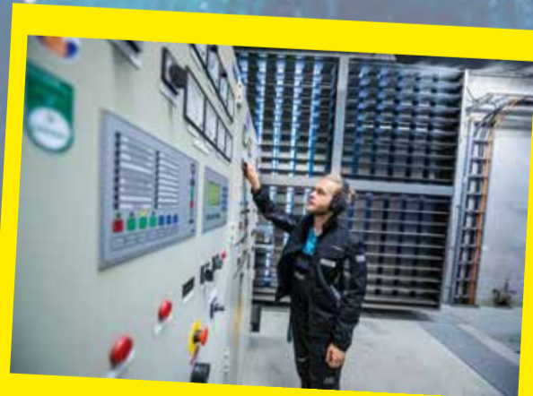
Hochmoderne elektronische Steuerungsanlagen bilden die Schaltzentrale ...
